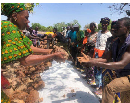
Les bénéficiaires de la commune de Tchériba à pied d'œuvre pour la construction des diguettes
